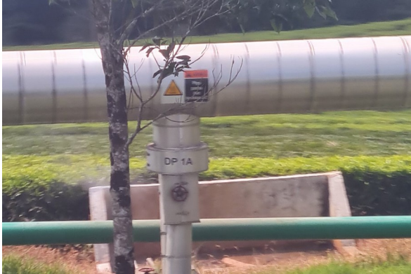
Jaringan pipa uap (gathering system) PLTP Patuha.
